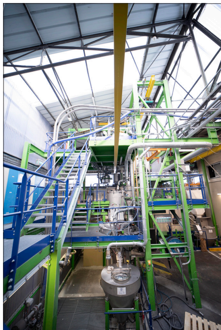
À gauche : Vue intérieure de l'usine de production. Crédit : Benvic.
