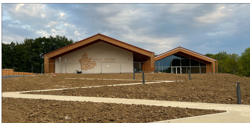
Le ciel s'est fortement assombri pour la piscine intercommunale de Puisaye-Forterre depuis que le président de l'intercommunalité, Jean-Philippe Saulnier-Arrighi, a dénoncé des malfaçons sur la charpente, repoussant sine die son ouverture au public. Crédit : JDP
