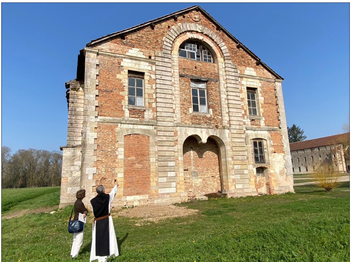
Le pignon de l'ancienne chapelle du définitoire avant le début des travaux. Crédit : DR / Abbaye de Cîteaux
